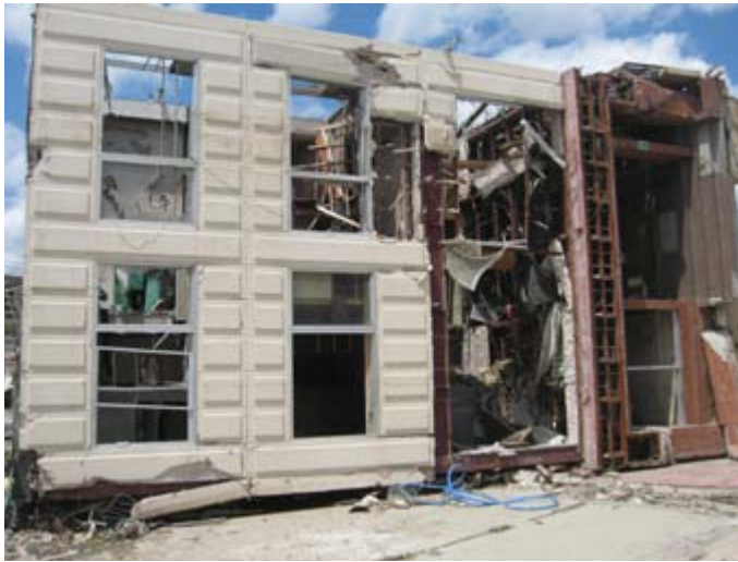
津波で倒壊した建物(女川町)
