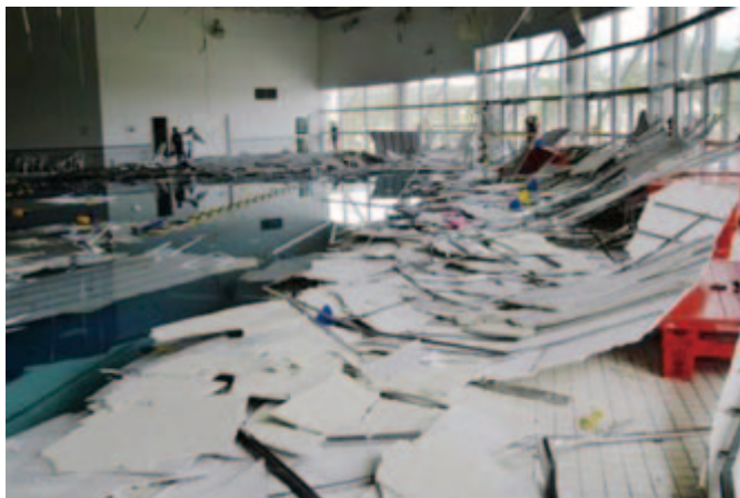
2011年3.11宮城地震 スポパーク松森内のプール施設天井が崩落**
