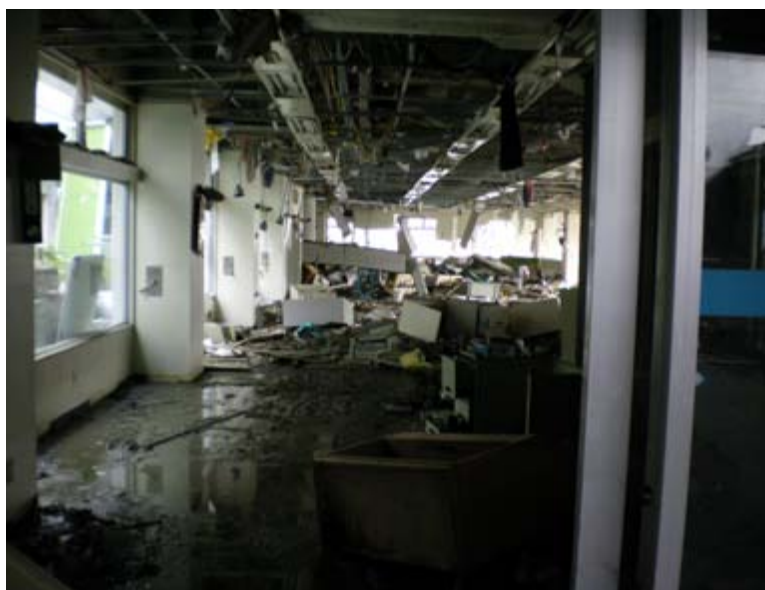
津波によって完全に破壊された雄勝総合支所
